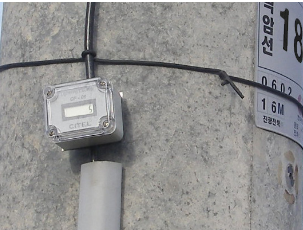
〈그림 5〉 낙뢰카운터기 설치 2
