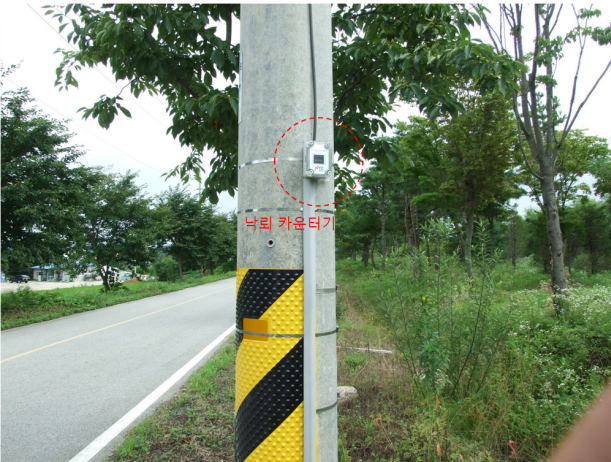
〈그림 4〉 낙뢰카운터기 설치 1
