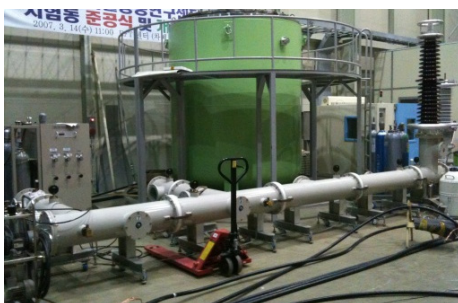
〈그림 1〉 모의 실험용 170kV GIS Mockup
