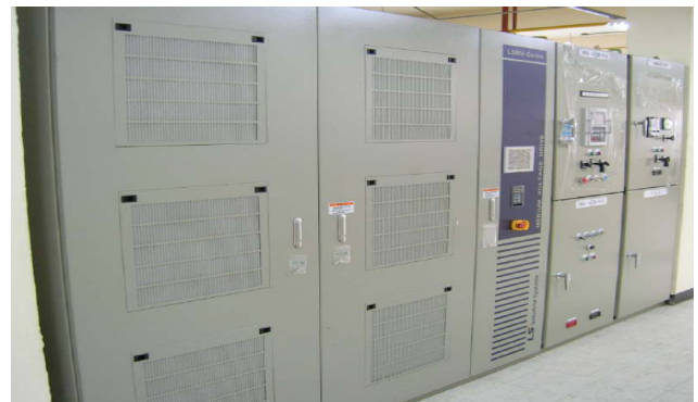
<그림 1> 설치된 자사 고압 인버터
