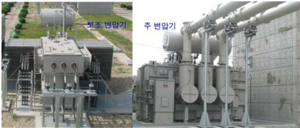
그림 3 100 MVA STATCOM 의 보조변압기 및 주 변압기 Fig. 3 Aux. and Main Transformer
