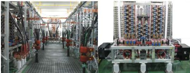
그림 4 인버터실 및 인버터 폴 사진 Fig. 4 Inverter hall and Inverter pole
