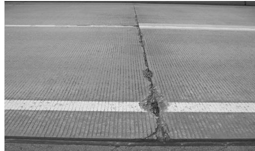
그림 2. B노선 줄눈부 파손 포장 구간
