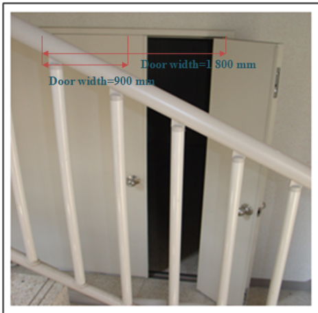
Fig. 1 외여닫이형태의 방화문의 설치 사례.
