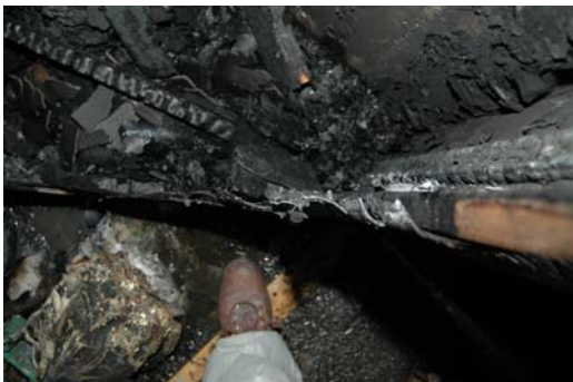
Figure 10. 안방 출입문 : 외측에 비하여 내측의 소실정도가 큼
