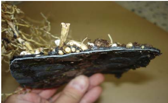
사진 3. 방근 기술을 사용한 방수층의 상태
