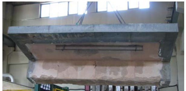
사진 2. ISO 온도가열 곡선에 따른 시험체의 폭렬 성상(슬래브)
