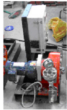
(d) 혼화제 공급 펌프
