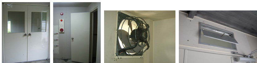
그림 2. 계단실과 화재실 방화문, 제연설비 제어패널과 화재실 개구부(배연기)
