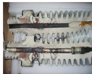
<그림 2> 부식의 파손
