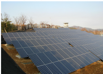
〈그림1〉 태양광발전설비 전경
