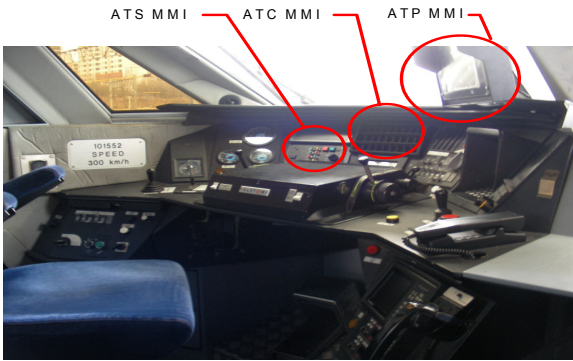
〈그림 5〉 KTX에 설치된 ATS/ATC/ATP장치 예
