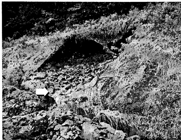
그림 6. 붕괴 비탈면에서의 지하수 유출(비탈면 파괴 당시)
