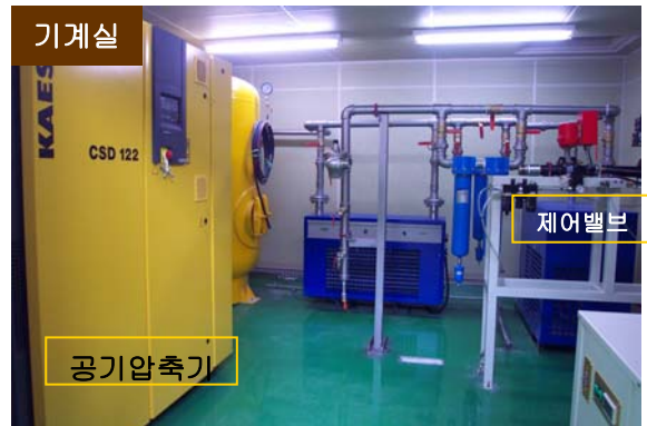
(b) 기계실 시험장치 사진
