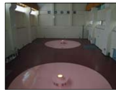
(c) 지하 1층 수차발전기실의 정면
