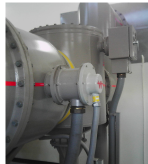
〈그림 7〉 실제 운전 중인 GIS에 설치된 Semi-내장형 UHF PD 센서
