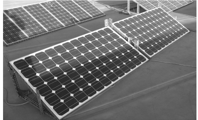
<그림 4> 건물에 설치된 Solar array
