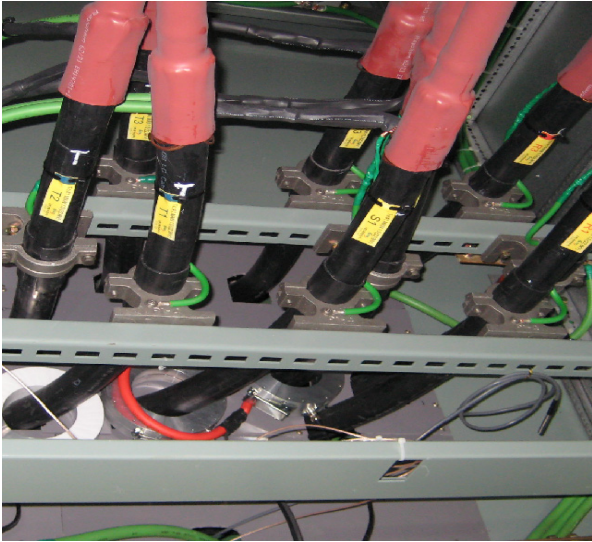
〈그림 2〉 HFCT 센서와 22.9kV케이블단말
