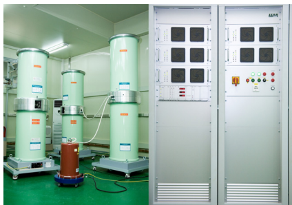
〈그림 1〉 200 kV 전류변성기 교정시스템의 실물사진
