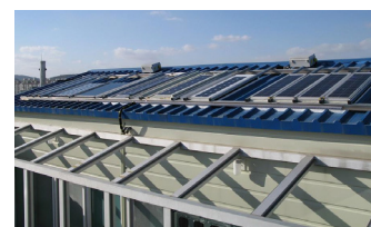
〈그림 2〉 지붕형 PV모듈 설치 전경
