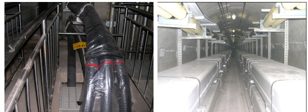
<그림 2> 지하전력구에 설치한 송전케이블 및 유선통신시설
