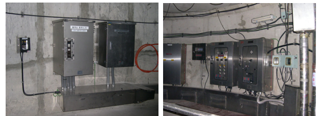
<그림 3> 지하전력구내부에 설치한 전기 및 통신 설비
