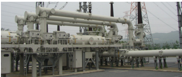
<그림 1> 765kV 변전소 내 GIS 설비
