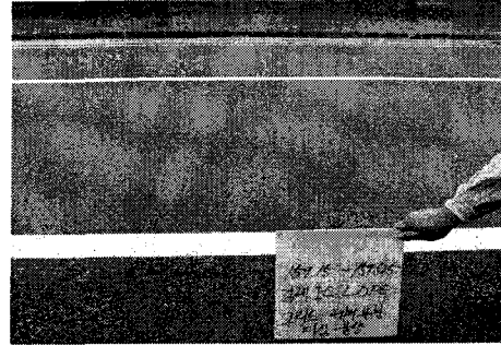
Fig. 12. Grid 제거 부분의 반사균열 발생
