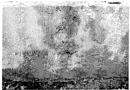
그림 4. Transverse crack in 36 year old CRCP
