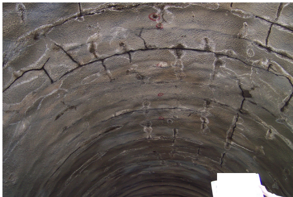
터널 천단부 균열 및 누수 현황
