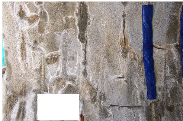
터널 측벽부 균열 및 누수 현황
