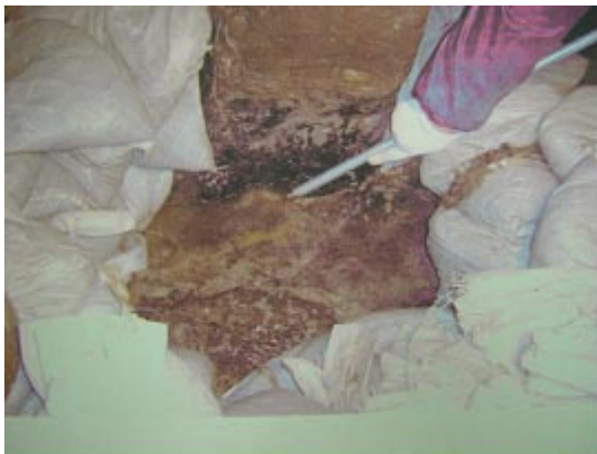
그림 13. 하수박스 연결부 균열
