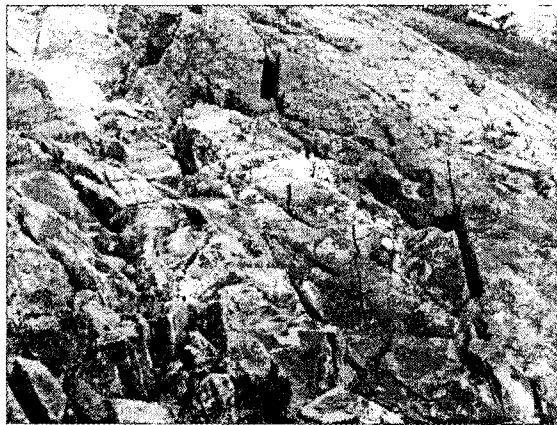
그림 4. 붕괴된 부분의 상단에 인장으로 균열 발생
