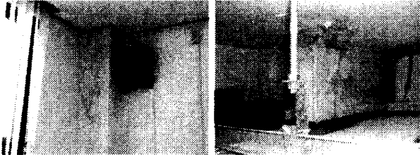
사진 1. 기동균열로 인한 누수
