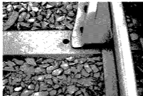
그림 7. 초기의 체결장치와 균열
