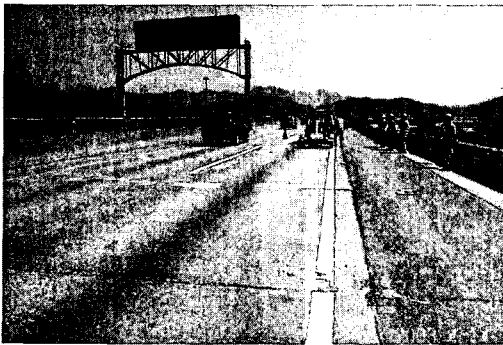
그림 1 줄눈부 보수 및 파손(중부선)
