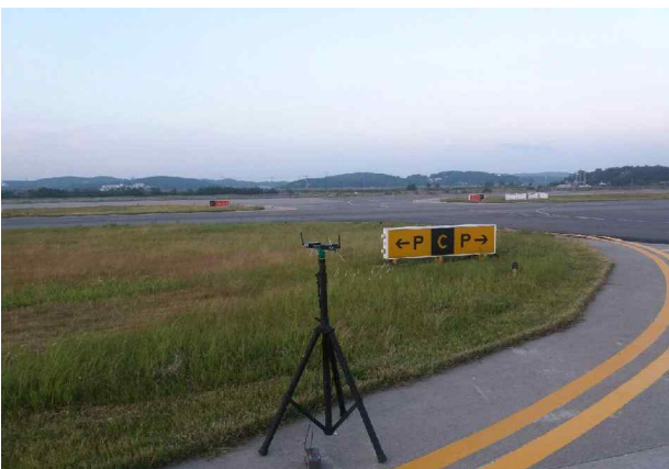
그림 5. 지상 중계기. Fig. 5. Ground repeater.
